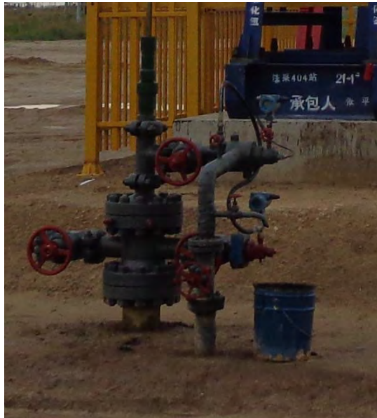
图 3-2 套管气回收装置
